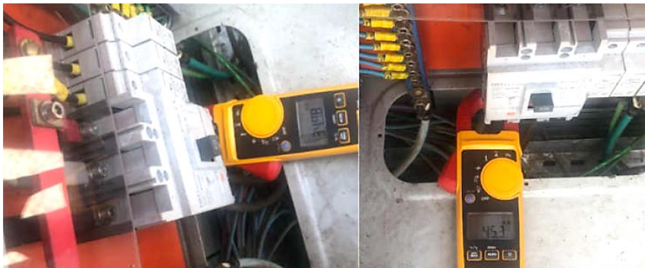
Foto 4 – Medições de Tensão e Corrente do arranjo fotovoltaico após as adequações.
