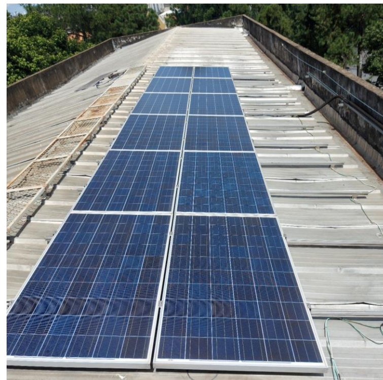
Foto 2 – Lado Oeste do gerador fotovoltaico: não será utilizado.
